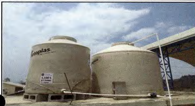
Foto 7: Accesorios de depósitos de agua y tubería de agua potable
